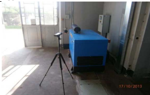
Misura del rumore presso la Centrale Petiva
