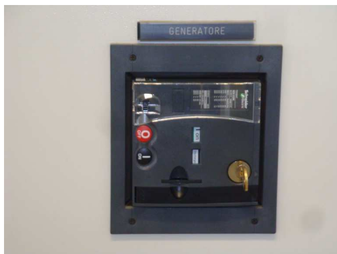
Nuovo interruttore di parallelo
