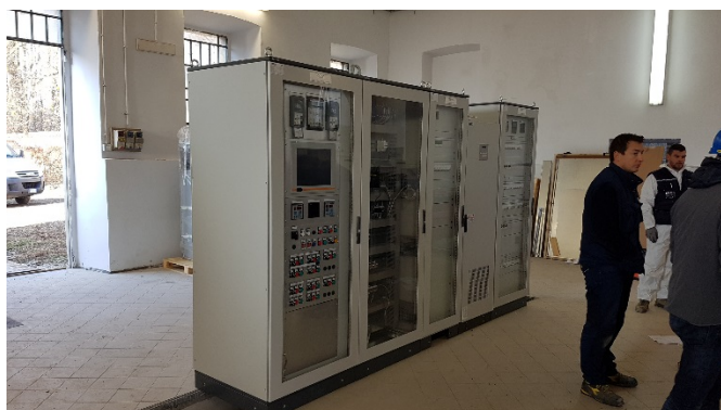
Quadri di comando e automazione
